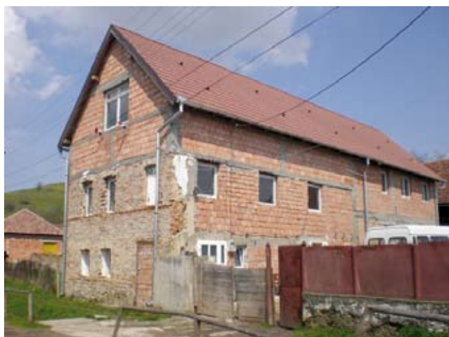
Unsere Hausfassade muss dringend isoliert und verputzt werden. - Helfen Sie mit?
